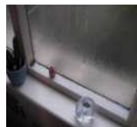
Bild 9. Kondens på insidan av fönstret är en tydlig varningssignal om att ventilationen inne kan vara låg i förhållande till fuktproduktionen. (Foto: Anneling Tobin Consult AB)
