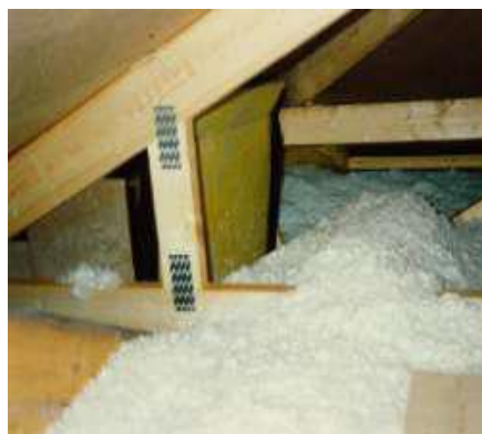
Bild 17. Konsekvensen av bristfälligt lufttät anslutning mellan avstängare och hammarband vilket innebär att isoleringen blåser undan. (Foto: Anneling Tobin Consult AB)
