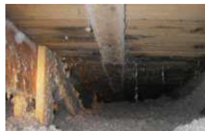
Bild 15. Efter ett par år har skadorna blivit mer omfattande och utbyte av delar av underlagstaket kan bli aktuellt. (Foto: Anneling Tobin Consult AB)
