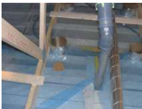
Bild 20. Stora brister i foliens lufttätet mot genomföringar. Isolering kan ej ske! (Foto: Anneling Tobin Consult AB)
