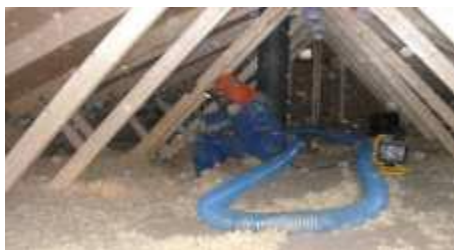
Bild 18. Efter isoleringen är det betydligt mer svåråtkomligt för korrigerande åtgärder! (Foto: Anneling Tobin Consult AB)
