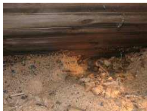
Bild 7. Tecken på uppträngande fuktig inomhusluft som kondenserar mot underlagstakets kalla yta. Tilläggsisolera inte utan att först ha åtgärdat problemet. Lösningen är inte fler ventiler i yttertaket utan kräver oftast en översyn av ventilationen inomhus och ev. förbättring av lufttätheten i vindsbjälklaget. (Foto: Anneling Tobin Consult AB)
