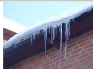
Bild 2. Istappsbildning orsakad av värmen från vindsutrymmet. (Foto: Anneling Tobin Consult AB)
