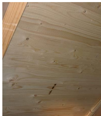
Bild 1. Ingen synlig påväxt men riklig påväxt enligt den mikrobiologiska analysen. Detta är normalt ingen skada - återkommande kontroll är alltid att rekommendera! (Foto: Anneling Tobin Consult AB)
