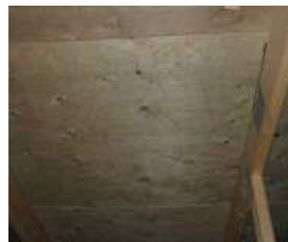
Bild 23 Mikrobiell påväxt på några år gamla underlagstak över välventilerade vindsutrymmen utan "felutförande". På råspontunderlagstaket kan i detta fall materialhanteringen före takläggning ha inverkat för uppkomsten av påväxt. (Foto: Anneling Tobin Consult AB)
