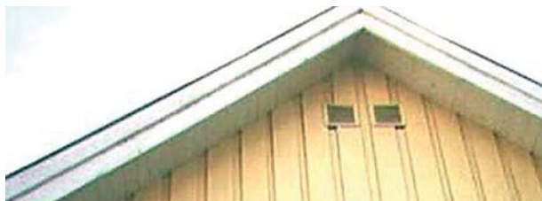
Bild 4. Ett par gavelventiler räcker
